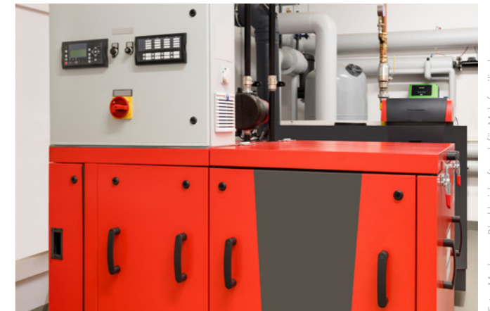
Foto: Modernes Blockheizkraftwerk für Mehrfamilienhaus
